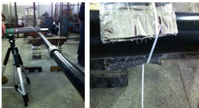
Рис. 4. Магнитный экран, надвинутый поверх кабеля
